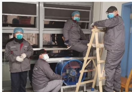
日立中央空调服务商助力武汉同济医院
